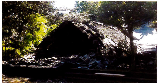
倒壊した拜殿
