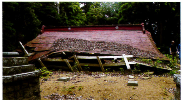
未だ倒壊したままの御社殿 (双葉町 諏訪神社)
